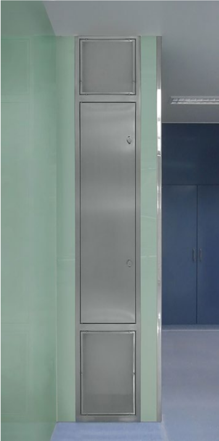
Abluftschrank inklusive Flusenabscheider und Servicetür
